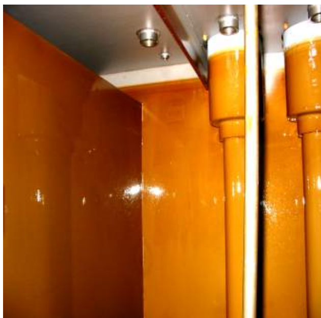
Рис. 2 – Лаковые отложения внутри масляного бака
