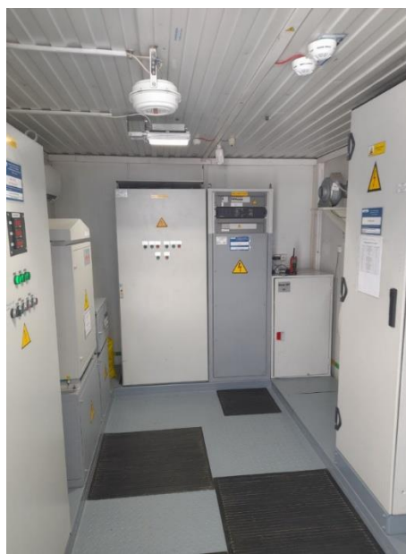
Рис. 2. Блок-бокс ПКУ, вид внутри
